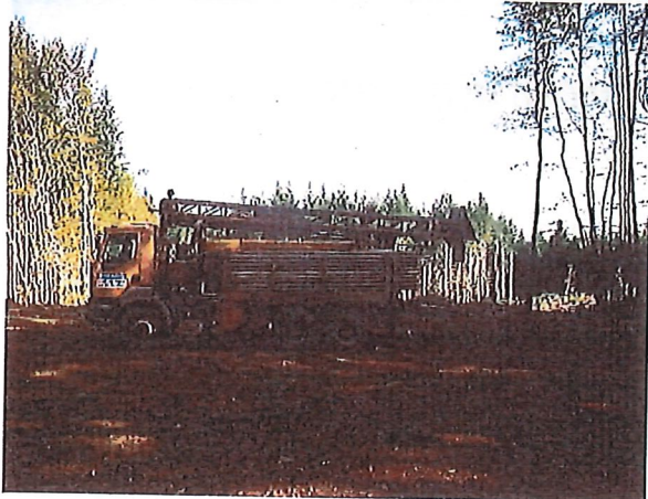
Mise en place de la foreuse à l'aplomb de l'implantation du forage
